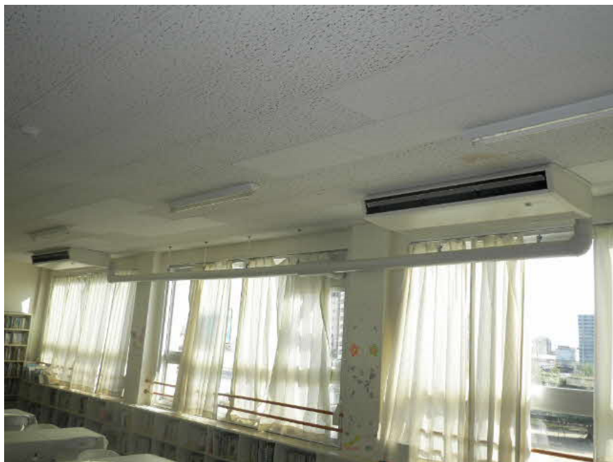
空調整備後の特別教室(岡富小学校)
