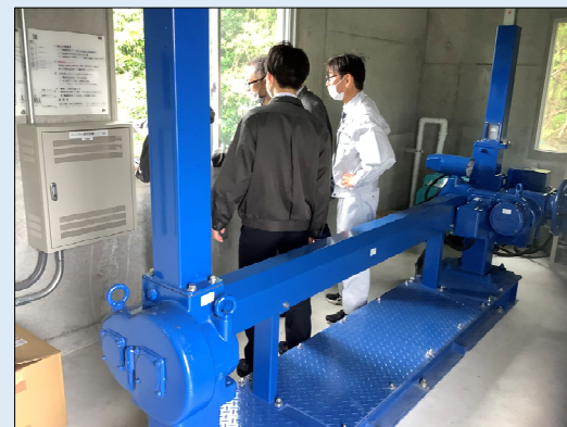
延岡市土地改良区(樋門操作室)
